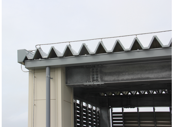
写真2 避雷導体（多賀地区津波避難タワー屋上）
